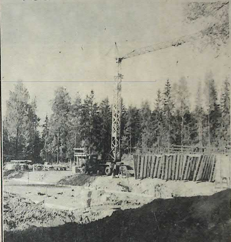
Vid byggnadsplatsen där de nya HSB-husen kommer att uppföras har man nu kommit så långt att man skall börja uppförandet av det första huset. En stor byggnadskran finns på plats, och väldiga jordmassor har schaktats bort. Snart kommer bilden att vara helt förändrad.
